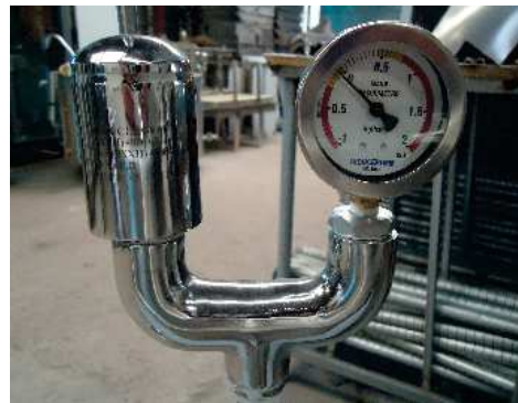
Foto 01 - Válvula de descarga e Manômetro
